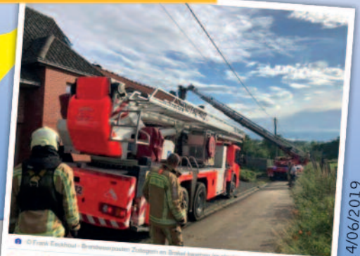
Actueel Een bliksemingslag trof donderdagavond de woning van de Zottegemse schepen Matthias Diependaele. De schouw en enkele dakpannen moesten eraan geloven.
